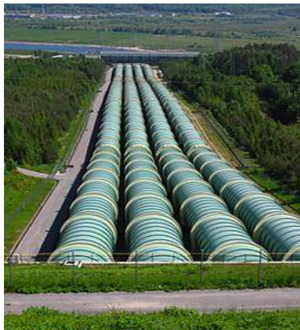
Elektrownia Szczytowo-Pompowa Żarnowiec w Czymanowie – rury, które łączą zbiorniki: górny i dolny
